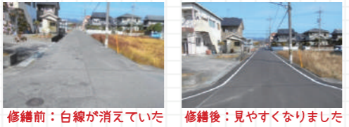
修繕前：白線が消えていた 修繕後：見やすくなりました
